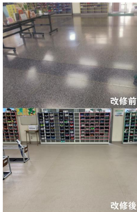
図3: 生徒が見つけた危険な場所が改修された例
